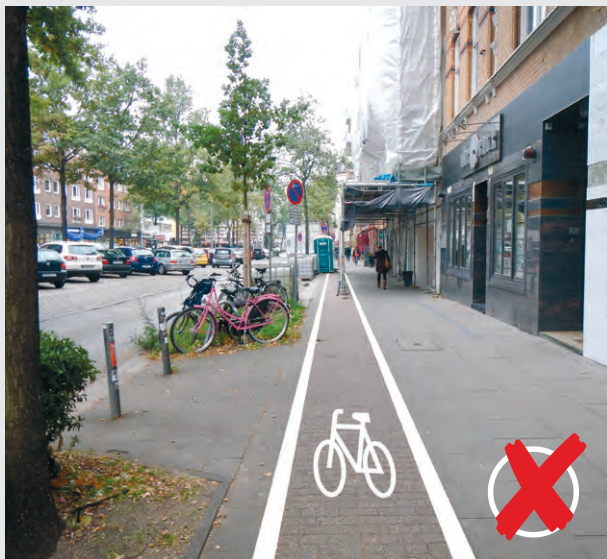
Bild 12 | Gerüst auf Radweg mit schlecht sichtbarer Sicherung
