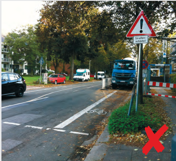
Bild 14 | Arbeitsstelle auf Radfahrstreifen ohne Absicherung
